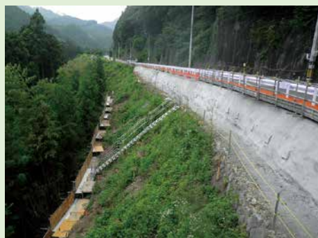
土砂流出防止柵(※)
