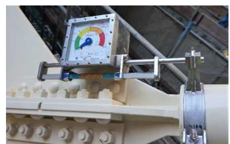
累積変位計設置
