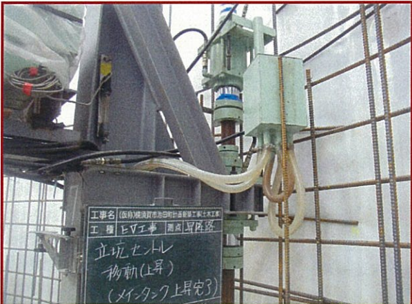
作業床上昇用ジャッキ
