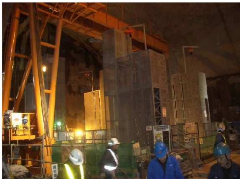
地下室に配置されたジャッキ機器 (コンパクトな機材で占有面積が少なく作業性がよい)
