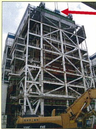
ボイラー外観
